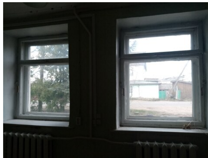
Окна помещения до ремонта. Варнавино, ул.Красноармейская, д.1а, 23.04.2023
