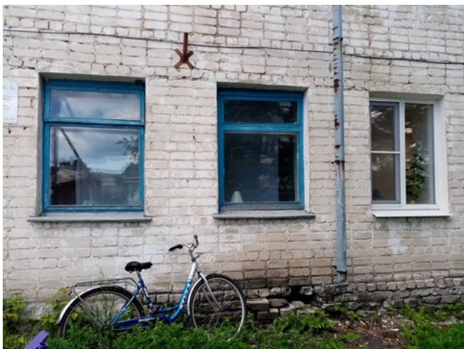
Окна помещения до ремонта. Варнавино, ул.Красноармейская, д.1а, 06.06.2023
